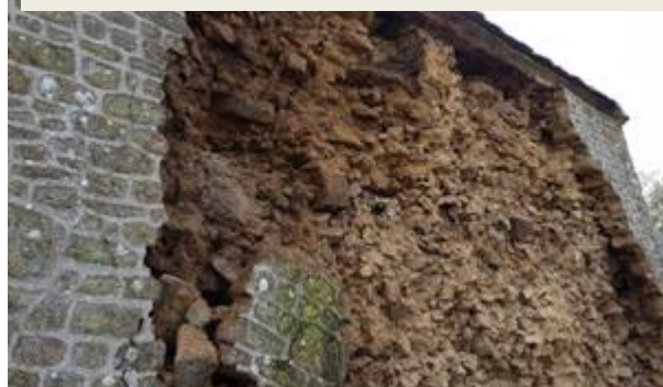
Exemple de flambage, évolutif d'un bouffement de mur
